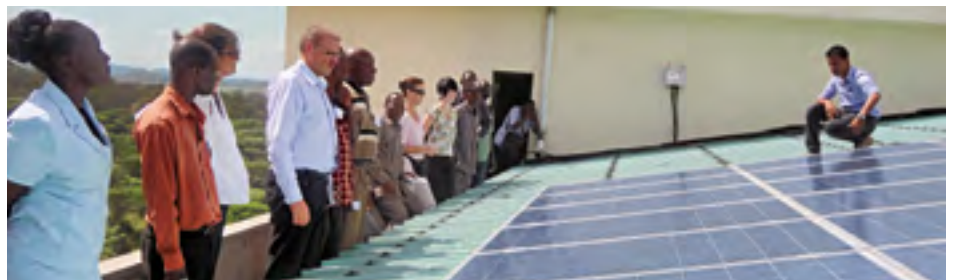
Endlich Licht im Lesesaal: Die Solaranlage auf dem Dach der Saint Augustine University in Mwanza, die 2010 installiert wurde, erzeugt Strom für die Versorgung der Universitätsbibliothek.
